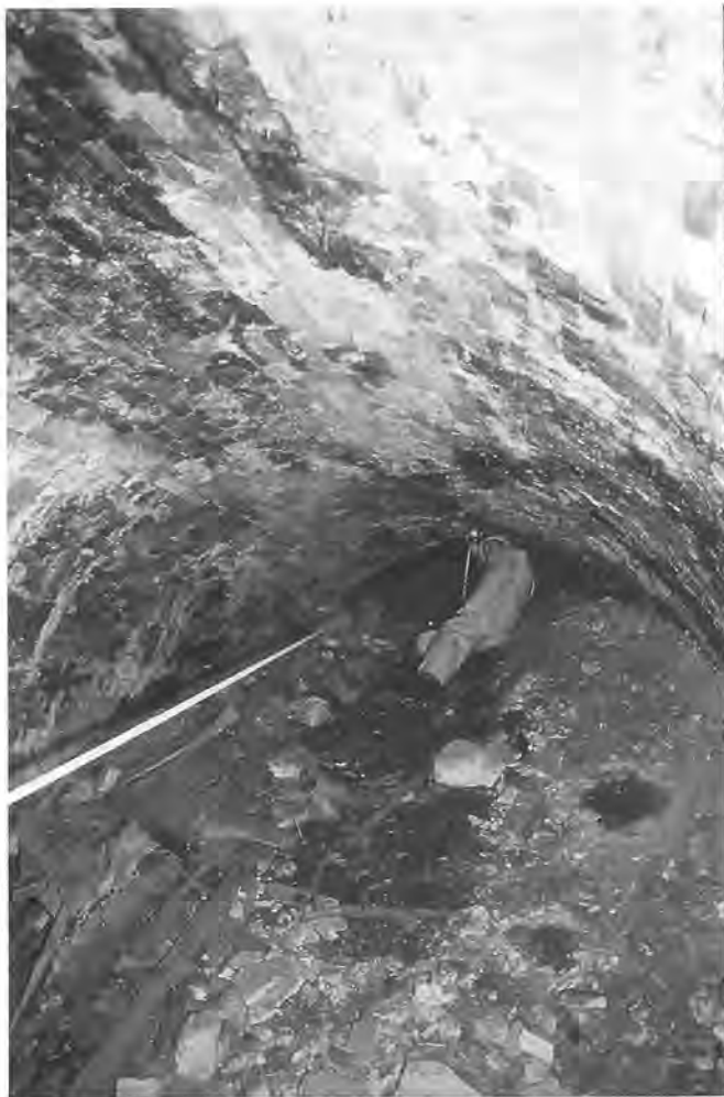
3. La camera di manovra del ponte levatoio nord, ingombra di rottami (foto di S. Di Benedetto).
