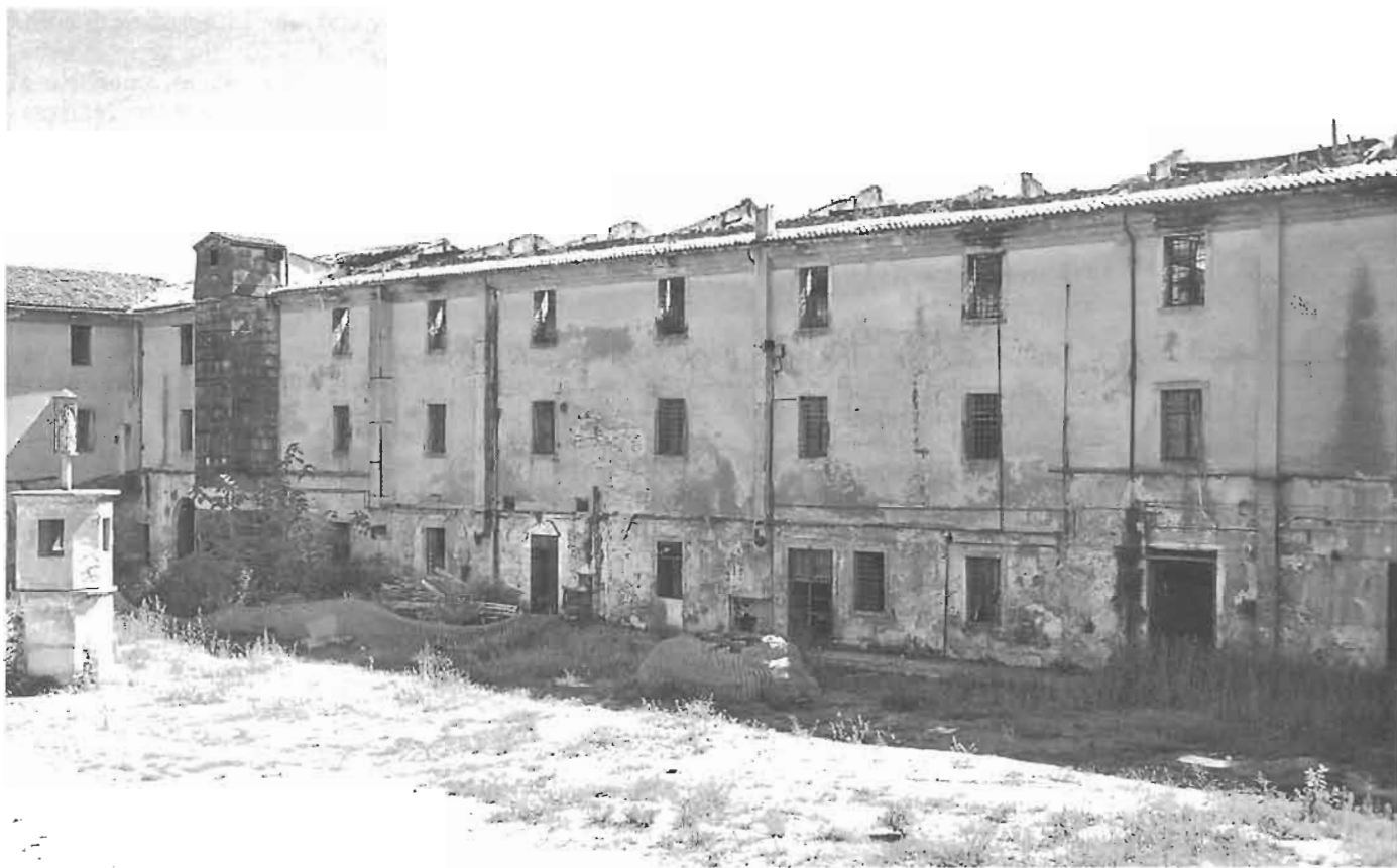
7. Il corpo meridionale dell'ex carcere in avanzato stato di degrado come appare ora, visto dal cortile interno.
