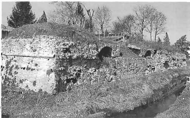
L'angolo di spalla tra fianco e fronte del baluardo Moro I. La faccia non è solo priva di incamicatura laterizia ma anche di una porzione del nucleo a sacco della struttura muraria interna, tanto che appaiono all'esterno le volte tra i contrafforti.
