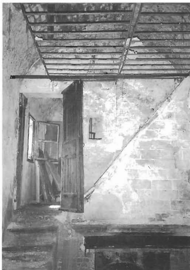
3. Padova, già convento di S. Maria dei Servi: particolare di un interno di una casa sita in vicolo Servi, in cui è visibile un piccolo focolaio con cappa in cotto; il soffitto è voltato a botte. Molto probabilmente si tratta della vecchia cucina del cenobio.
