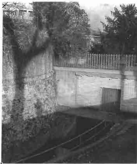
1 Moderna tecnologia contro antico bastione, al termine di Riviera Paleocapa, cioè in un punto delicato sia della cerchia muraria che dell'ambiente urbano.
